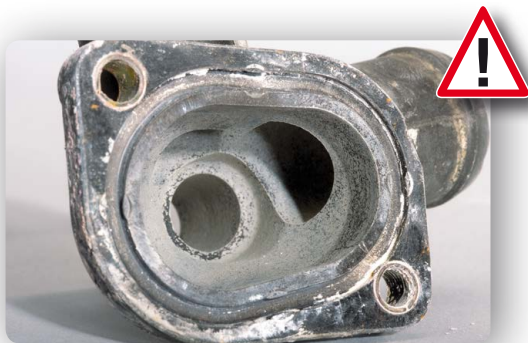
被水垢覆盖的管路
