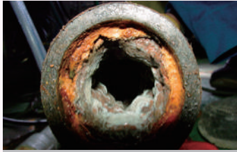
配管にスケールが固着！
