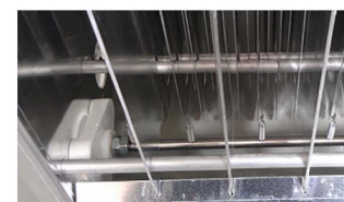
电场极板内部
