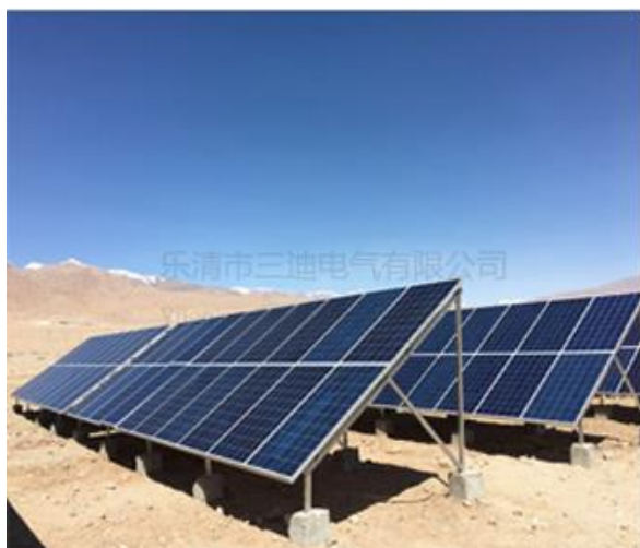
新疆63KW光伏扬水灌溉系统
