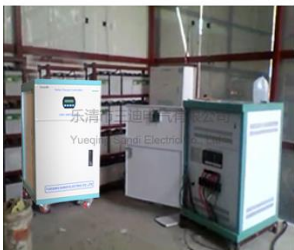
厄瓜多尔50KW水厂离网发电系统
