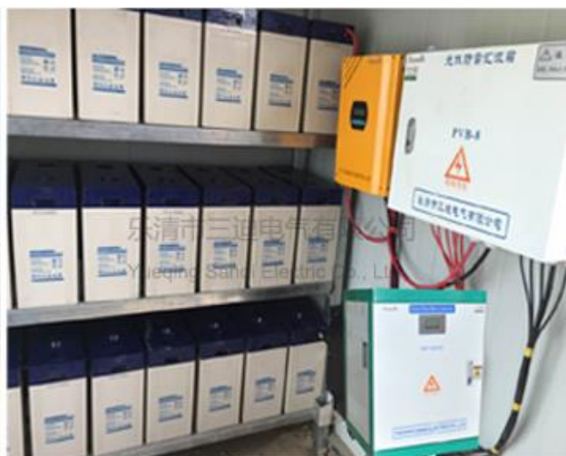
新疆5KW光伏离网发电系统
